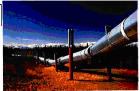
Le pipeline est un conduit qui sert au transport des produits pétroliers et du gaz naturel sur de longues distances.
